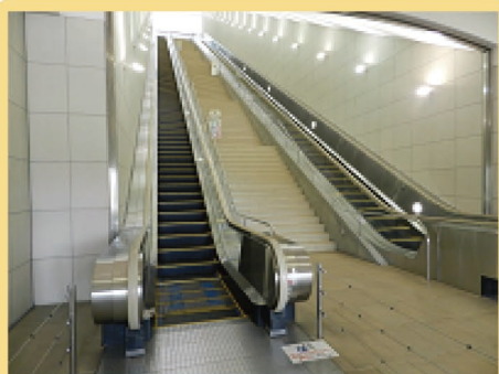
正面入口 エスカレーター
